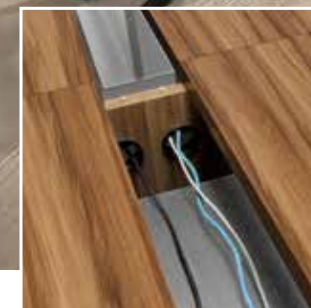
Duto para passagem de fiação.
